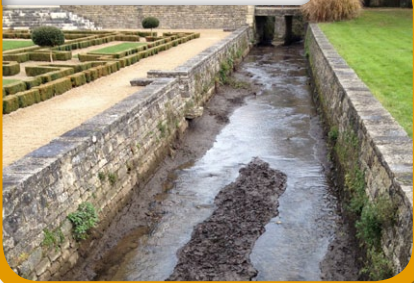
Envasement d'un cours d'eau
